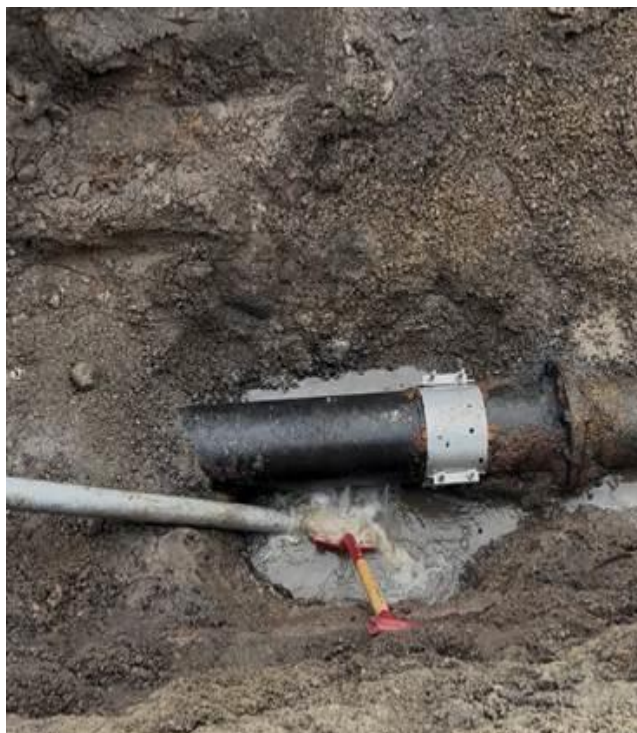
Lekkasje i Kabelvåg (Foto: Stig Rune Dybwig)
