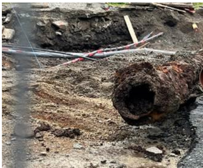
Eldre vannrør i Storgata (Foto: Stig Rune Dybwig)
