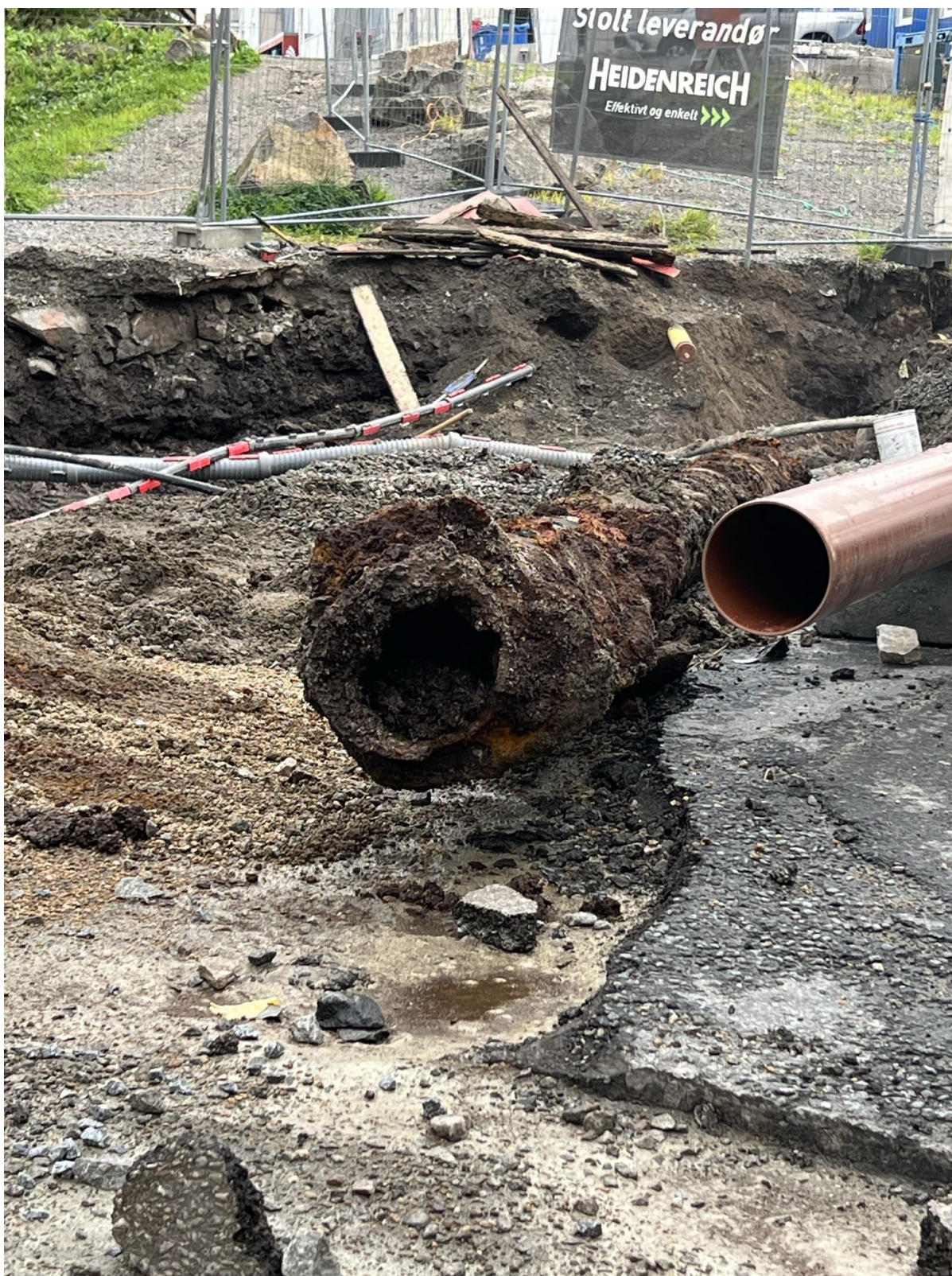
Arbeidet med Storgata. Gamle rør tas frem i dagslyset og erstattes av nye. (Bilde: Stig Rune Dybwig).
