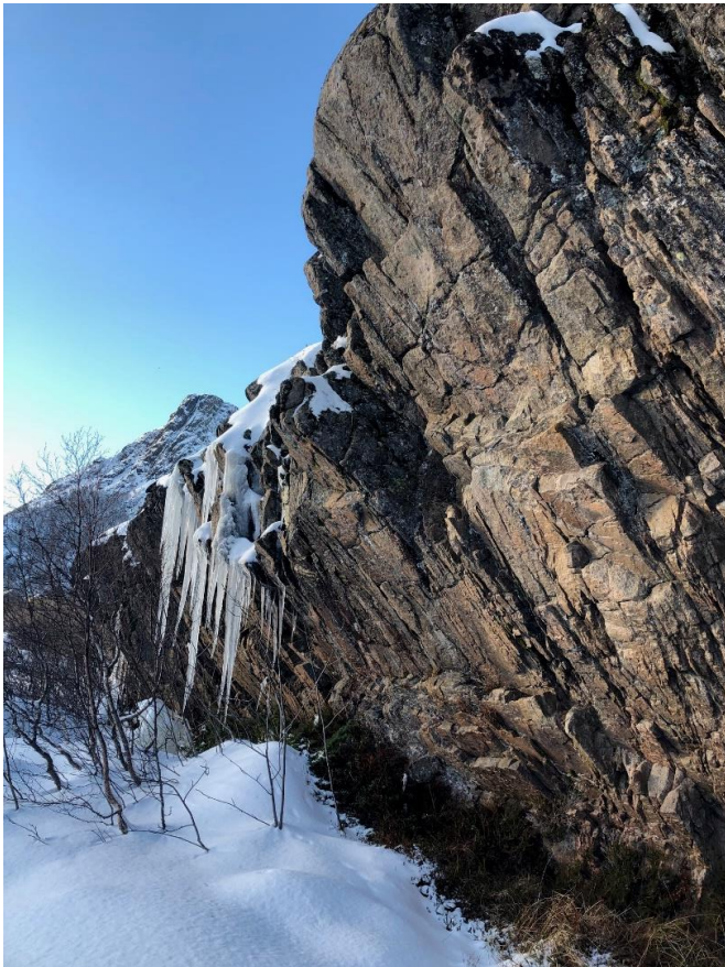
Bilde 7. Overhengende småfallent berg med isdannelse ved byggeområde nr. 3 (se figur 2), sett mot vest.
