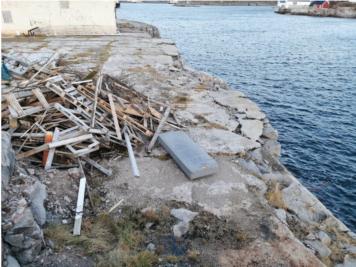
Figur 7: Mot øst er betongplate på grunn tidvis utvasket langs ytterkant. Bildet er tatt i retning nord.
